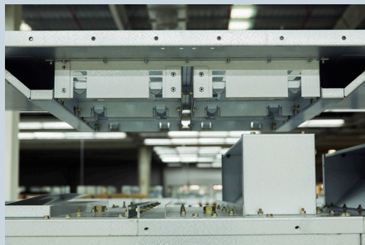
Канал сброса давления (часть)
