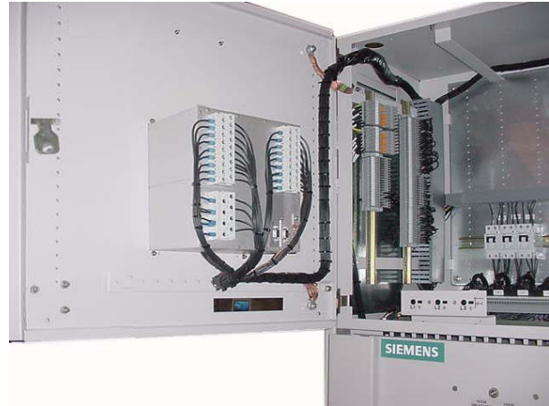
Рис. 39. Открытая низковольтная секция
