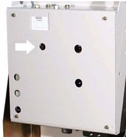
Рис. 55. Передняя часть силового выключателя ЗАК с рабочим отверстием для рукоятки, заряжающей замыкающий пружинный механизм вручную.
