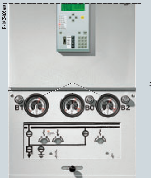
Манометры (3) для полюсов силового выключателя и разъединителя (расположены в передней панели)
