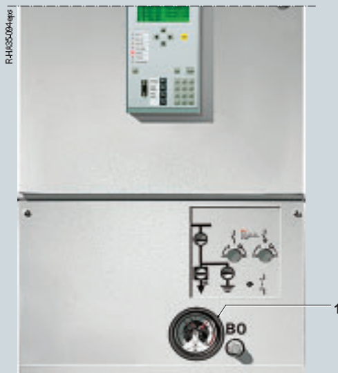
Манометр (1) для полюсов силового выключателя (расположен в передней панели устройства)
