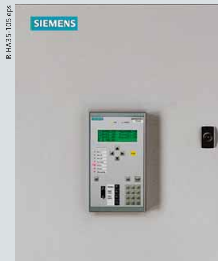
Низковольтный отсек с многофункциональным реле защиты SIPROTEC 4 7SJ61 (образец)
