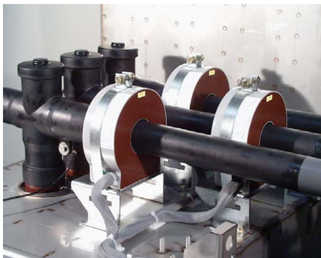
Рисунок 22: Несущие конструкции трансформаторов тока
